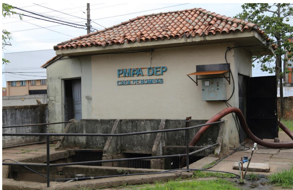
Figura 106. Casa de bombeamento em Humaitá-Navegantes
