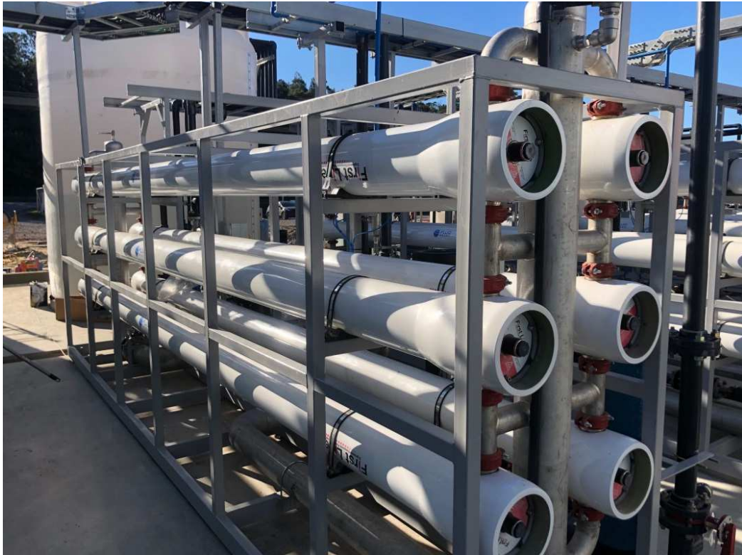
Figura 4.32 – Sistema de nanofiltração para tratamento de lixiviados
