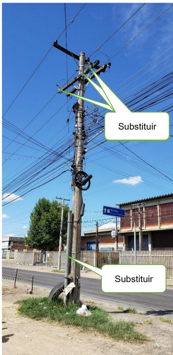
Foto 2. Poste CEEE. (não representa situação atual)
