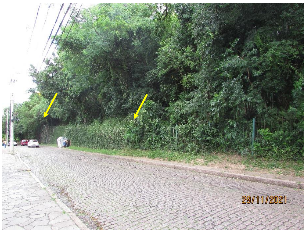
Figura 13. Vista do ponto mais alto da Rua Engenheiro Saldanha com identificação do intervalo do muro de contenção identificado pelas setas.
