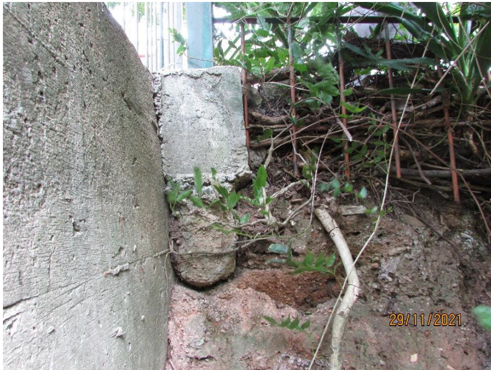
Figura 18. Extremo Norte da área, na divisa com um prédio residencial, o talude tem declividades próximas a 90° e o solo nesse ponto já foi parcialmente lixiviado.
