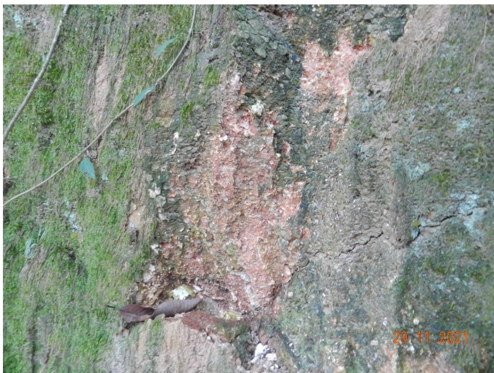
Figura 3 - Detalhe do granito alterado
