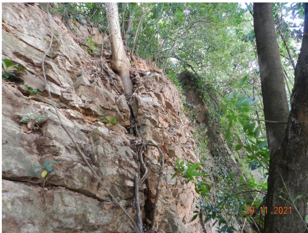
Figura 8. Vegetação entre as fraturas do veio de quartzo causando o afastamento de uma porção do material ao lado do muro de contenção nas cotas mais baixas.
