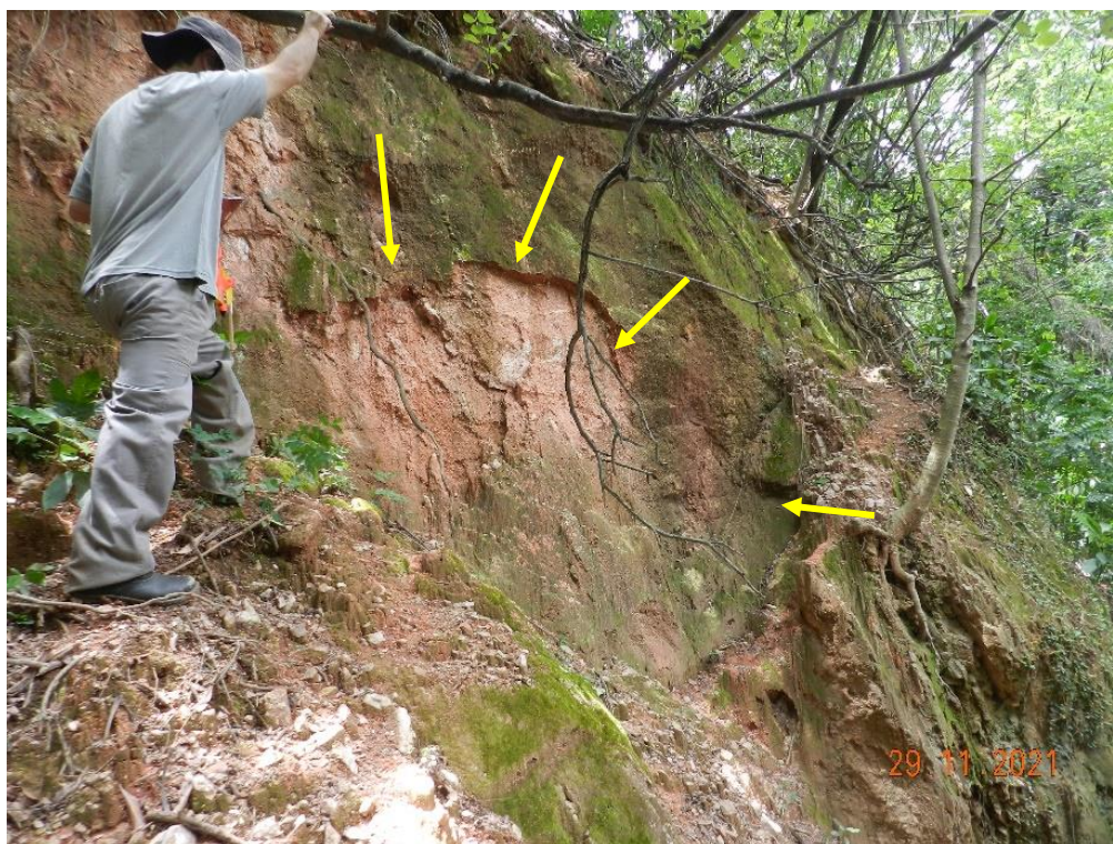
Figura 10. Ponto onde é possível observar uma fração da “capa” alterada da rocha granítica que se desprende do maciço identificado pelas setas.
