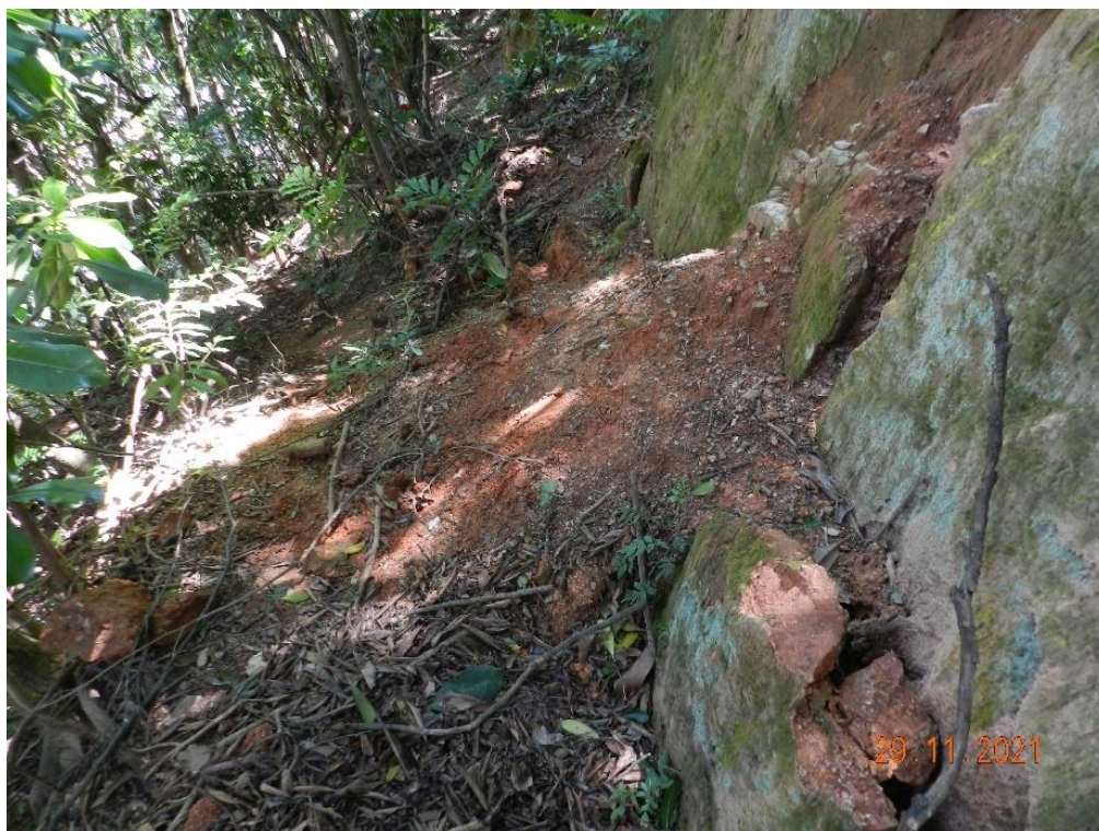
Figura 2 - Rocha granítica com alto grau de alteração depositando lentamente no pé do talude o material desprendido do maciço
