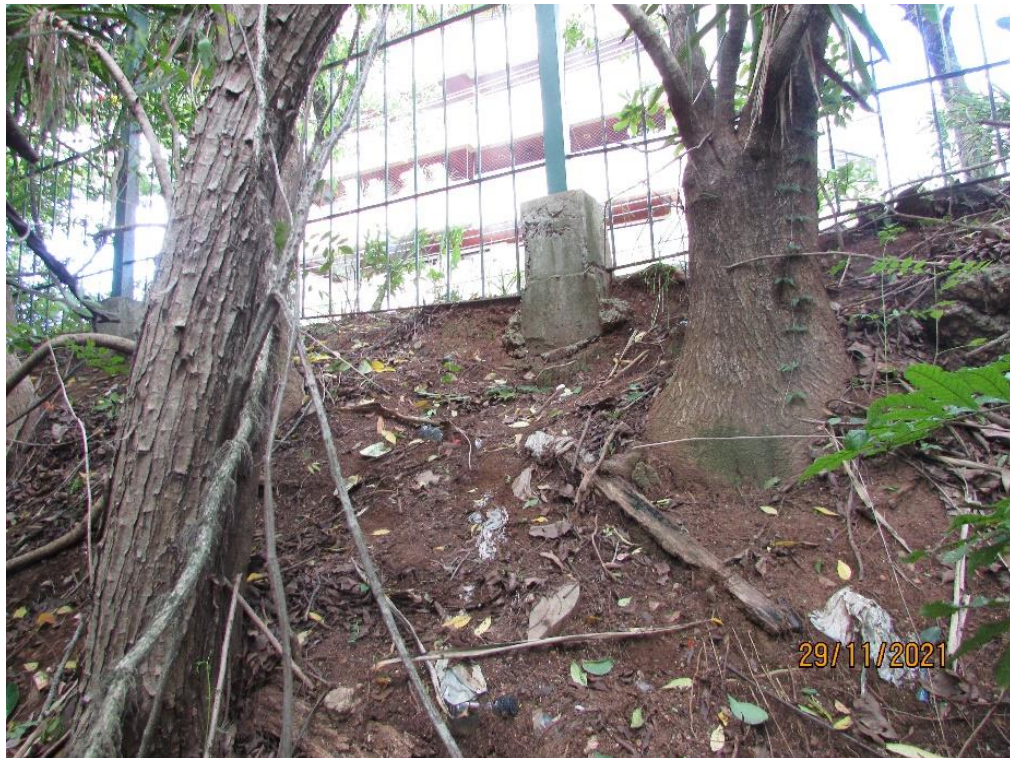
Figura 17. Ponto com a crista do talude próxima a calçada expondo uma fundação de concreto da grade por conta da lixiviação lenta de partículas de solo.
