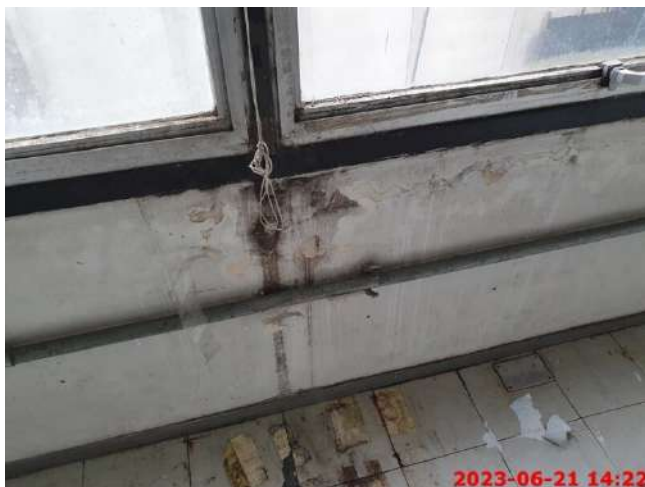
Foto 43 – Problemas de infiltrações junto as esquadrias
