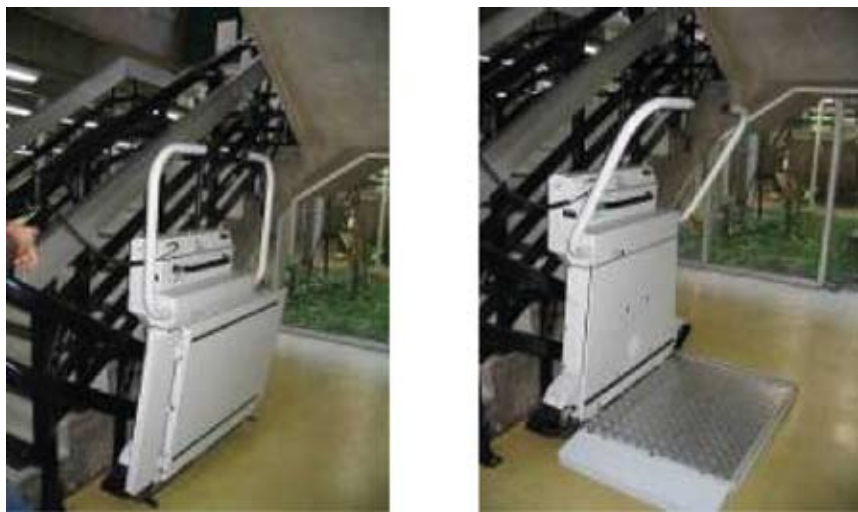
Fotos 06 e 07 - Plataforma basculante tipo inclinado
