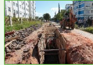
Adutora de Água Ouro Preto
